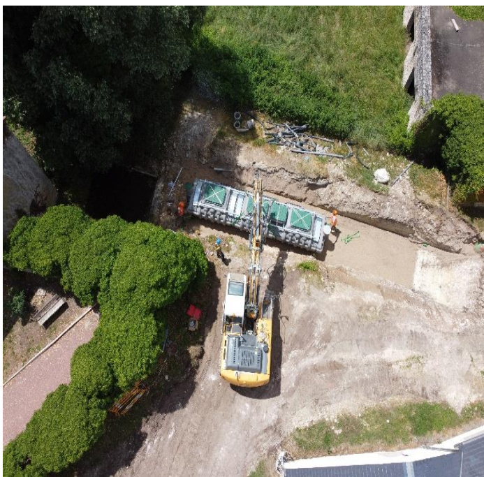
Station d'épuration de Malicorne à Dolus le Sec
