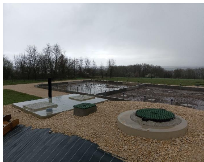
Station d'épuration de Bridoré
