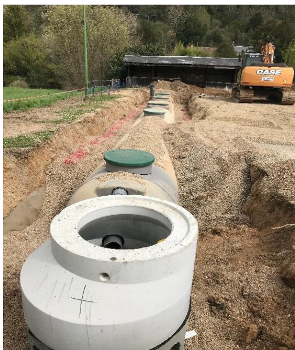
Station d'épuration de Chaumussay
